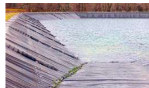
Bassin de stockage de Beaussiet (Mazerolles)
