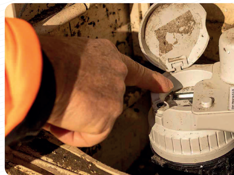
Vue d'un compteur télérelève
